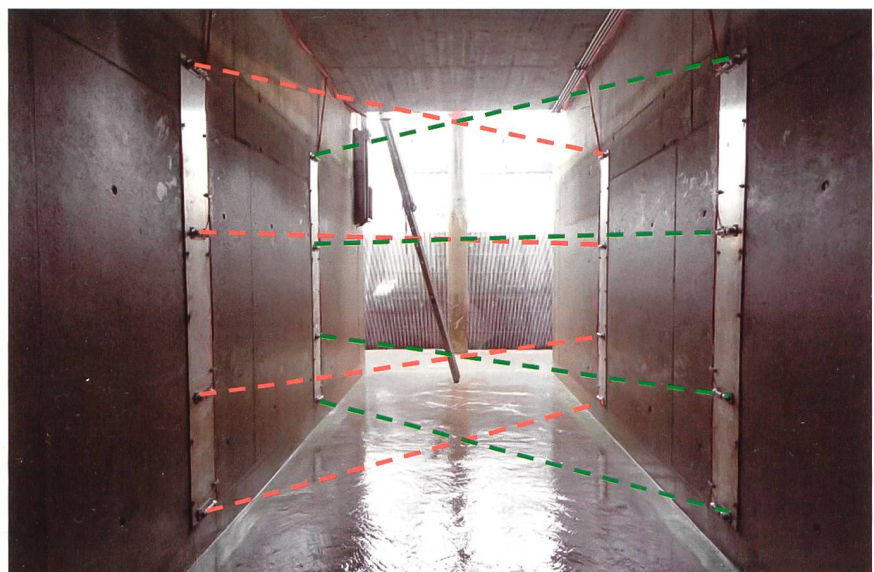
Bild 3 Temporär montierte und mit einem Theodoliten ausgemessene 8-pfadige gekreuzte akustische Volumenstrommessung im Einlaufkanal des Dotierkraftwerks Pradella, CH.
