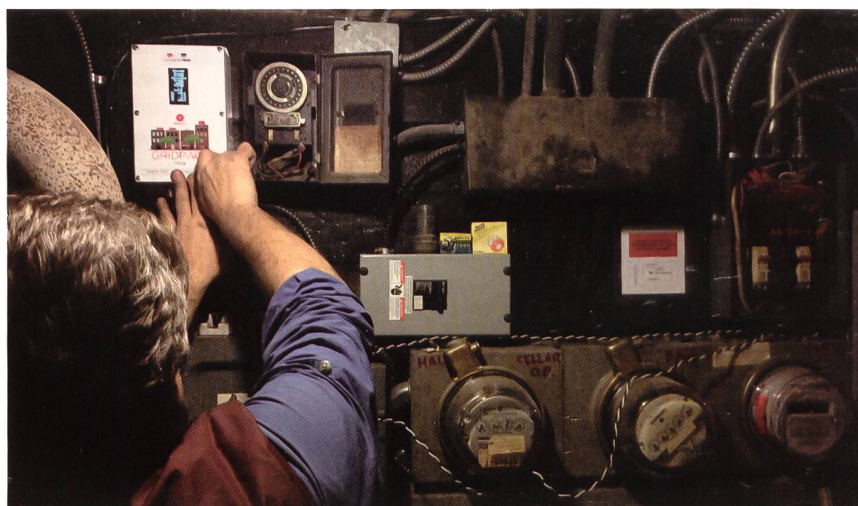
Mit dieser kleinen Box können die Teilnehmer ihren überschüssigen Strom in das lokale Netz einspeisen und hierfür eine Vergütung von den Abnehmern erhalten.
