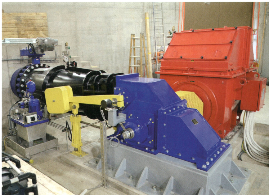
Ossberger-Durchströmturbine mit Generator.
