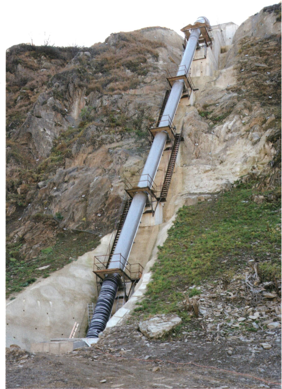
Druckleitung aus Stahl während der Bauphase. Die Treppen und Hilfskonstruktionen wurden anschliessend entfernt.
