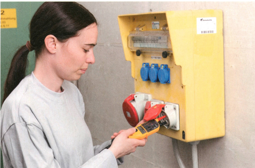
Bild 4 Messung bei einer Steckdose IP2X ohne PSA.
