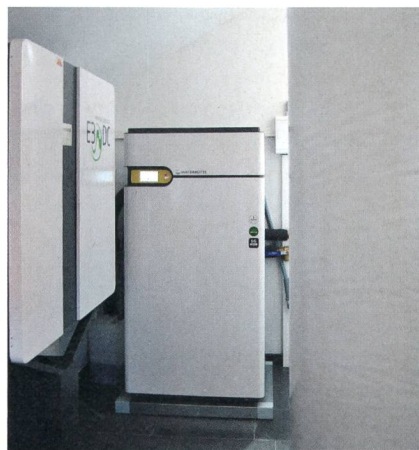
Das Hauskraftwerk (links im Bild) steuert im Solarhaus die Wärmepumpe und die Wallbox an.
