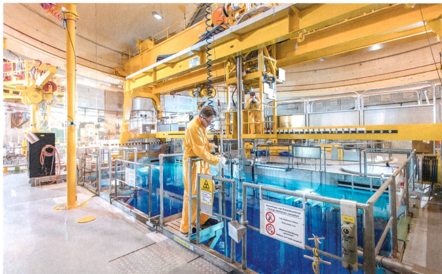
Am 20. Dezember 2019 wird das Kernkraftwerk Mühleberg (im Bild das Brennelement-Lagerbecken) abgeschaltet.
