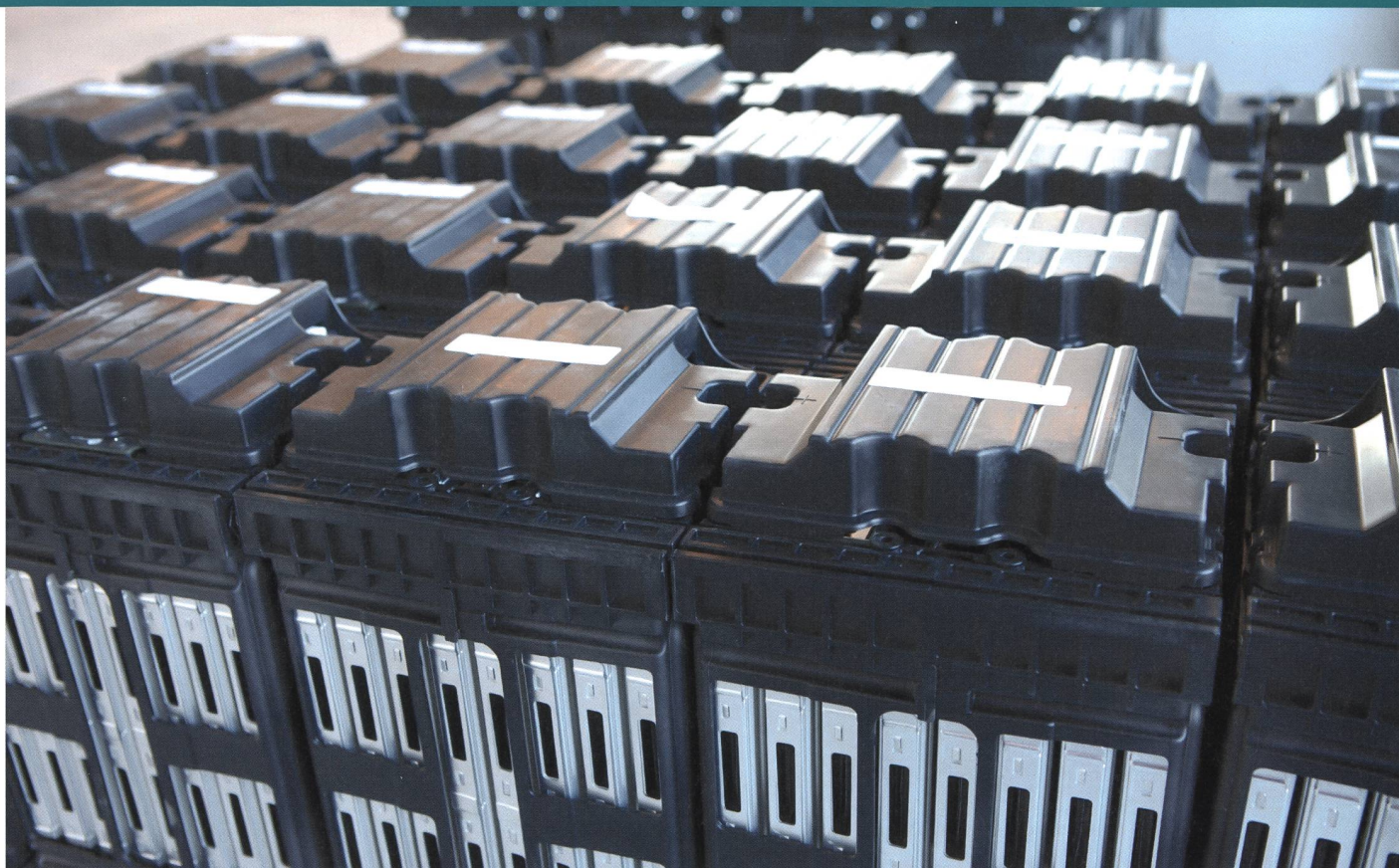
Speichermodule des grössten Schweizer Batteriespeichers in Volketswil.
