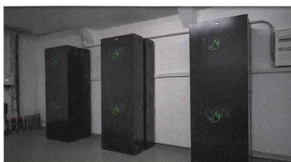
Die Quattroporte-Linea-Energiespeicher können jeweils 52 kWh speichern.
