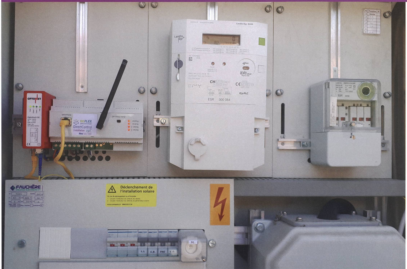
Coffret d'entrée d'une maison équipée de façon à pouvoir gérer son potentiel de flexibilité.
