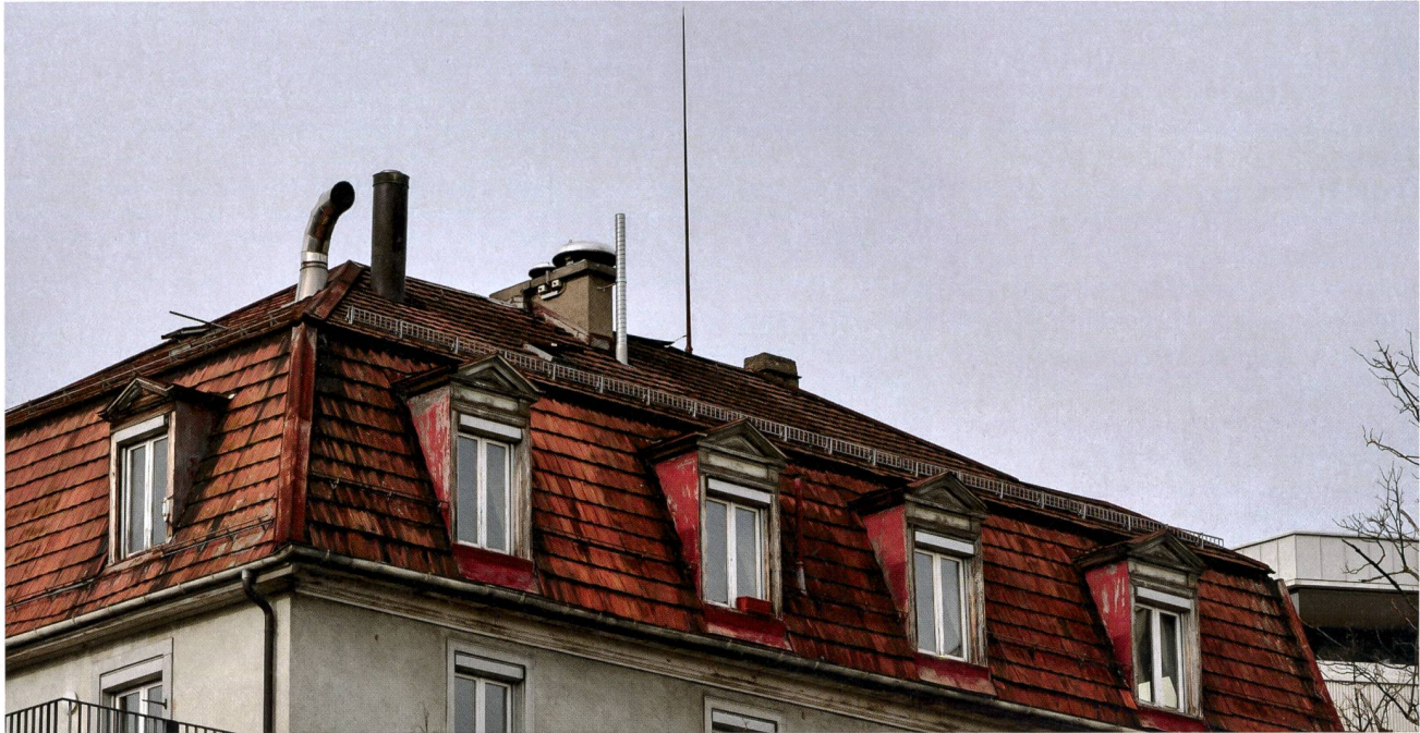
Äusserer Blitzschutz an Wohnhaus in Zürich.
