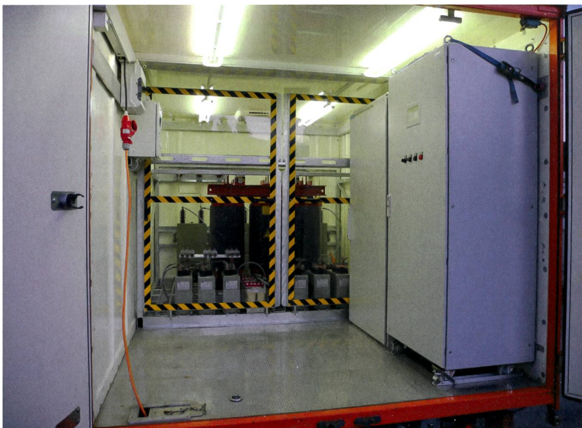
Bild 3 Das Innere der betriebsbereiten Rundsteueranlage.
