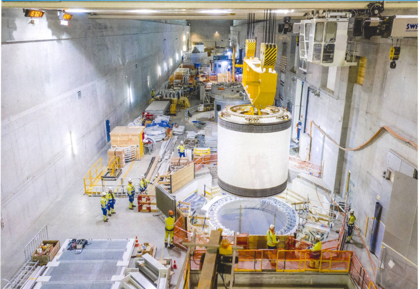
Maschinen im Kraftwerk Nant de Drance.
