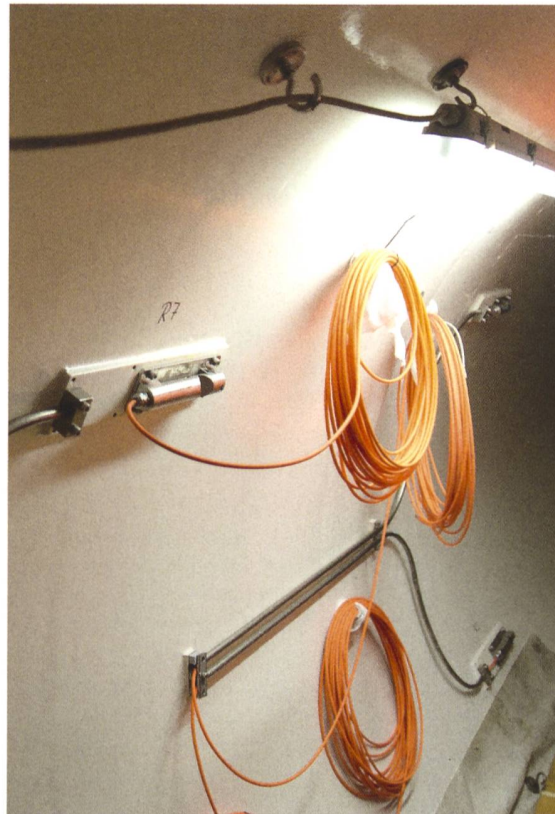
Bild 5 Die neuen Sensoren für die Durchflussmessung.
