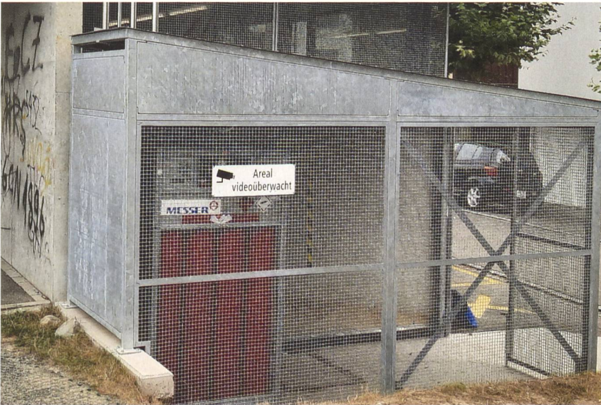
Bild 3 Aufstellung Wasserstoffzylinder zur Notstromversorgung.
