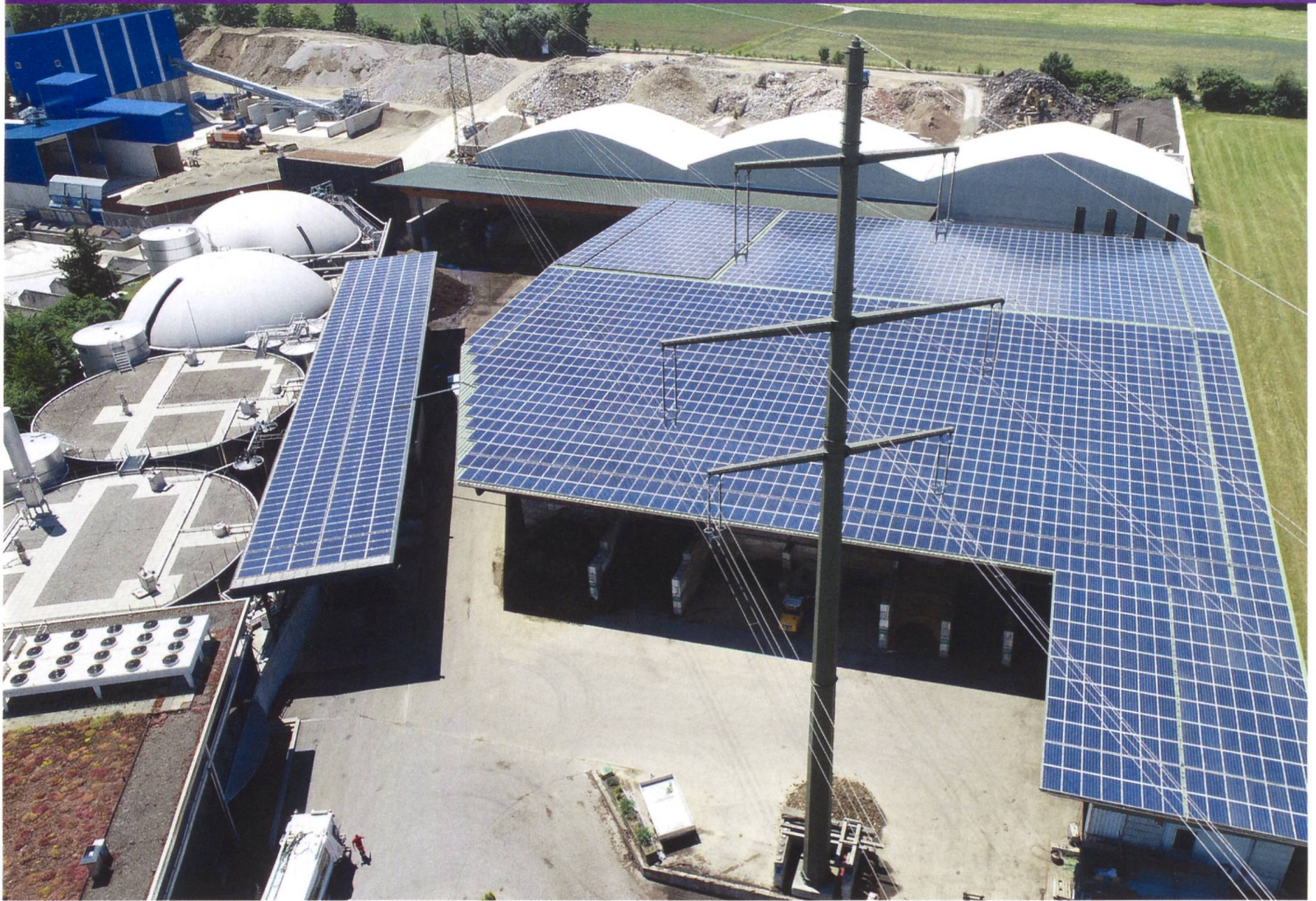
Eine PV-Anlage im Netz der AEW, bei der die Blindleistung geregelt wird, um das Netz zu stabilisieren.
