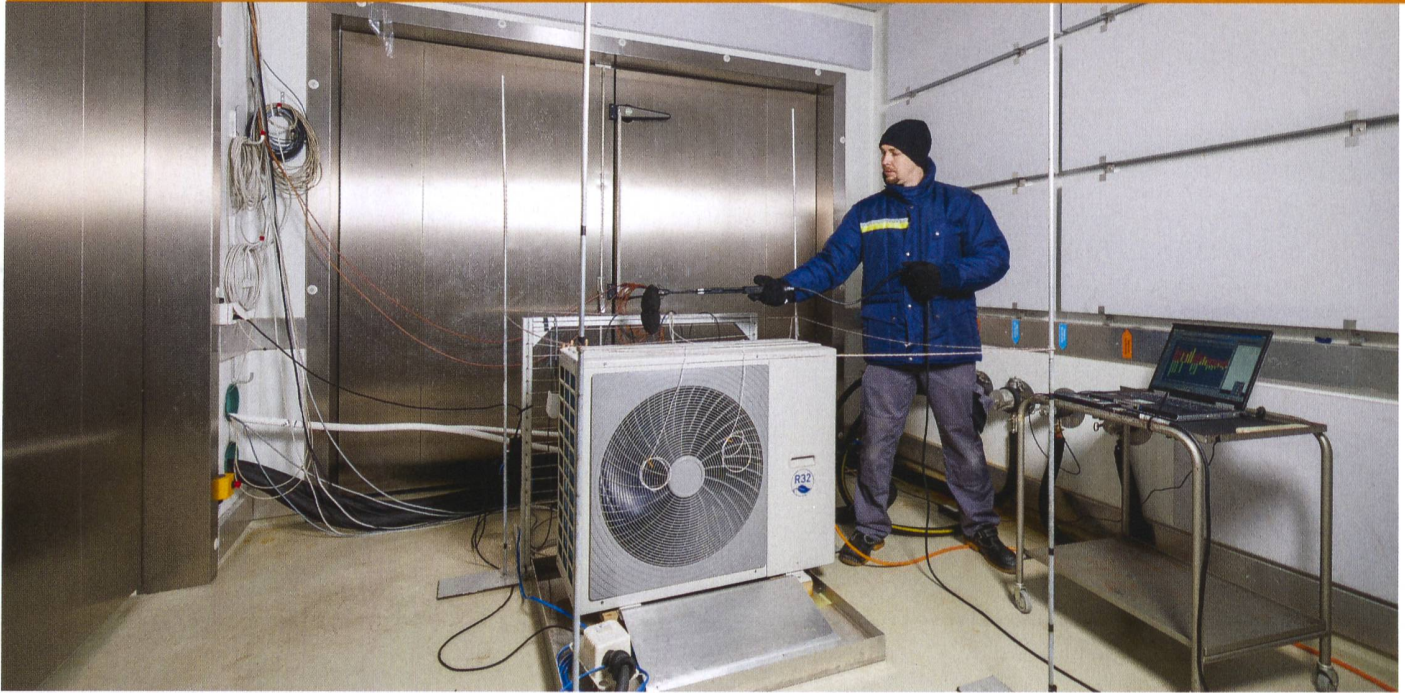
Luft-Wasser-Wärmepumpen-Test und Schallmessung am Wärmepumpen-Testzentrum (WPZ).
