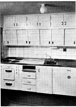
Die neuzeitlich eingerichtete Küche mit Herd, Chromstahlspülkessel, Boiler, Kühlschrank und Geschirrkasten.
