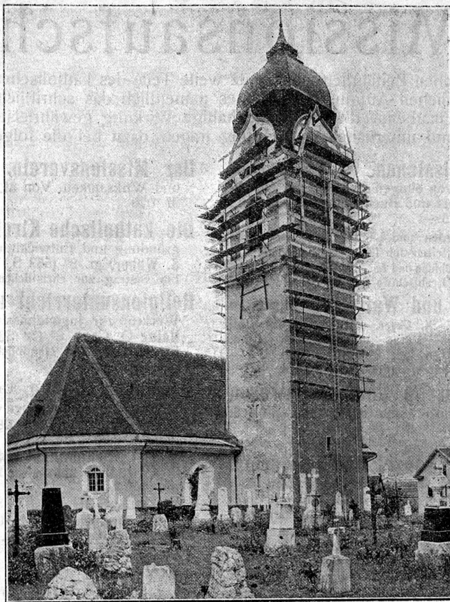
Turm-Gerüst, System „Blitz“ (für Uhr und Verputz-Reparaturen)
