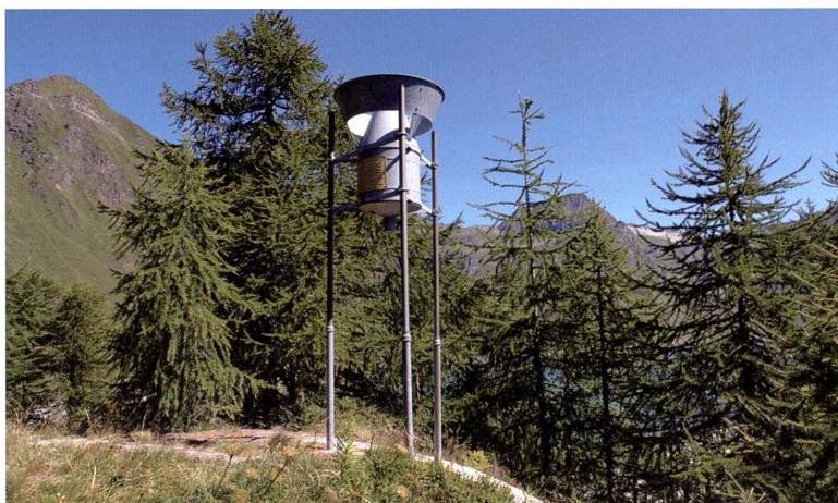
Fig. 3 – Pluviometro in località Bellavista. È il primo pluviometro totalizzatore entrato in esercizio nella regione di Piora. Fu installato il 10 novembre 1914 in zona Bellavista su uno sperone di roccia sopra il Lago Ritóm in prossimità del sentiero che porta a Föisc (foto F. Rampazzi).
