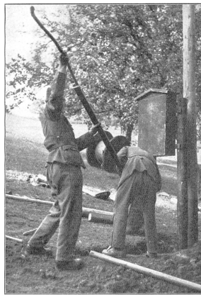
An ihren beiden Enden geht die Leitung in erdverlegte Kabel über, sie wird dadurch weniger empfindlich gegen Feindwirkung. (A Er 0304.)
