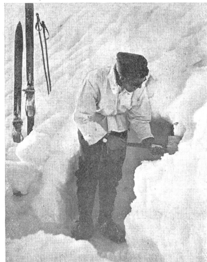
Aushub einer Schneehöhlen-Unterkunft für eine Gipfelbesatzung auf 4000 m ü. M. im rückwärtigen Firnhang. — Etablissement d'un cantonnement dans la neige à 4000 m d'altitude. — Lo scavo di una caverna nella neve, che servirà da ricovero per un presidio a 4000 m. s. m. (Zens.-Nr. VI H 4941.)
