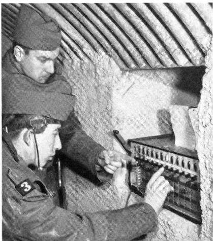
Im festgemauerten Unterstand bildet die Telefonzentrale den Knotenpunkt der Kabelverbindungen zur Front.
