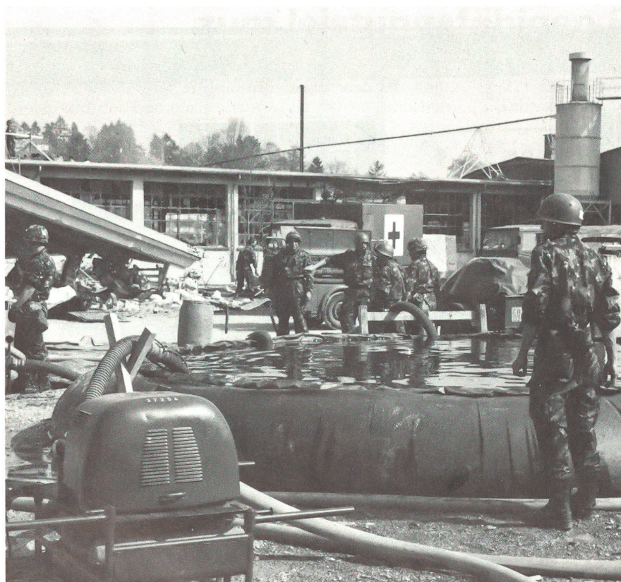
Mit Luft aufpumpbares Reservoir für das Löschwasser.
