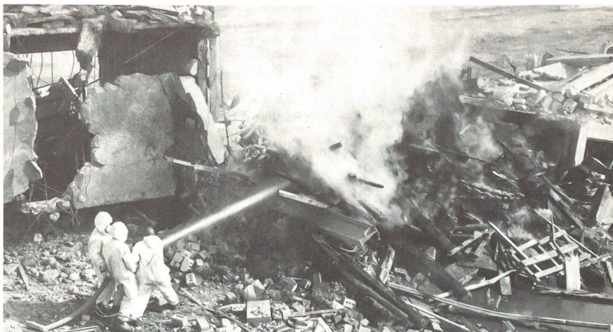
Immer wieder aufflammende Brandherde werden bekämpft.
