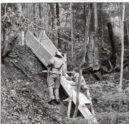
Ein Schuttkanal wird erstellt.
