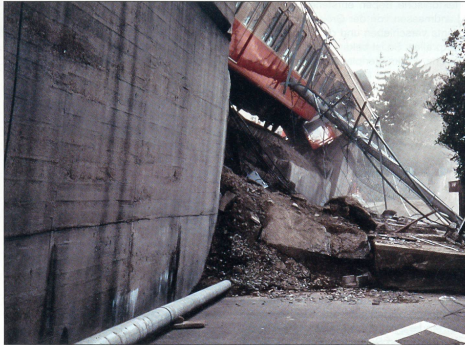
Zerstörungen an Verkehrsachsen und Werkleitungen.
