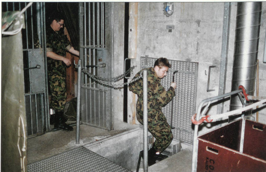
Unter der unscheinbaren Scheune verbirgt sich Hightech: Einstieg zur Vermittleranlage.
