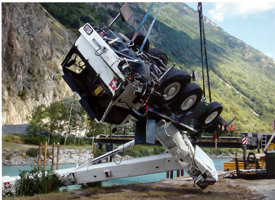
Der Unfallkran wird geborgen.
