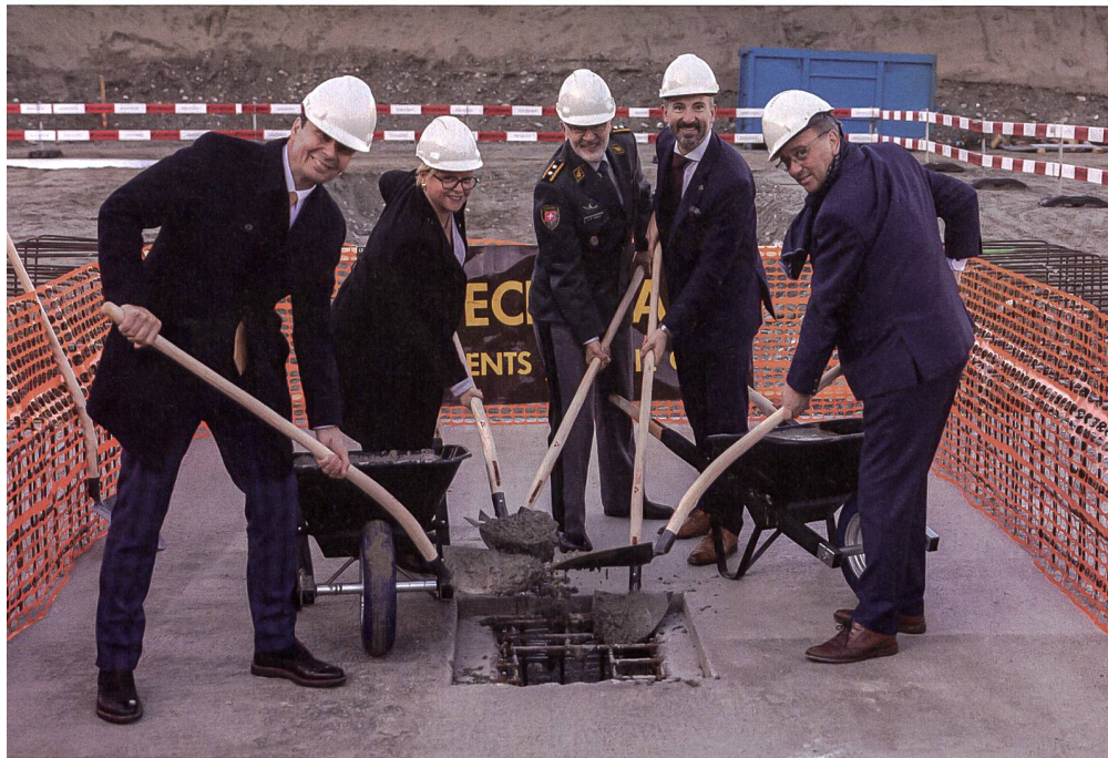
An der offiziellen Zeremonie zum Baubeginn der Indoor-Schiessanlage auf dem Areal der Militärkaserne in Sitten haben Vertreter der Schweizer Armee, des Kantons Wallis und der Stadt Sitten teilgenommen.
