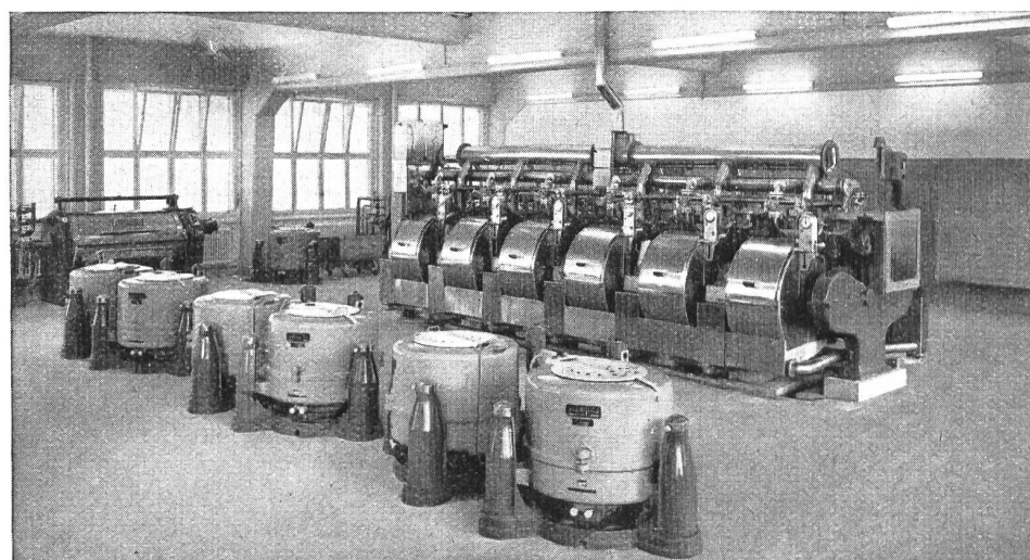
Wäschereianlage Kant.-Spital Winterthur
