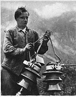
Präzisionsarbeit an der elektrischen Ausrüstung
