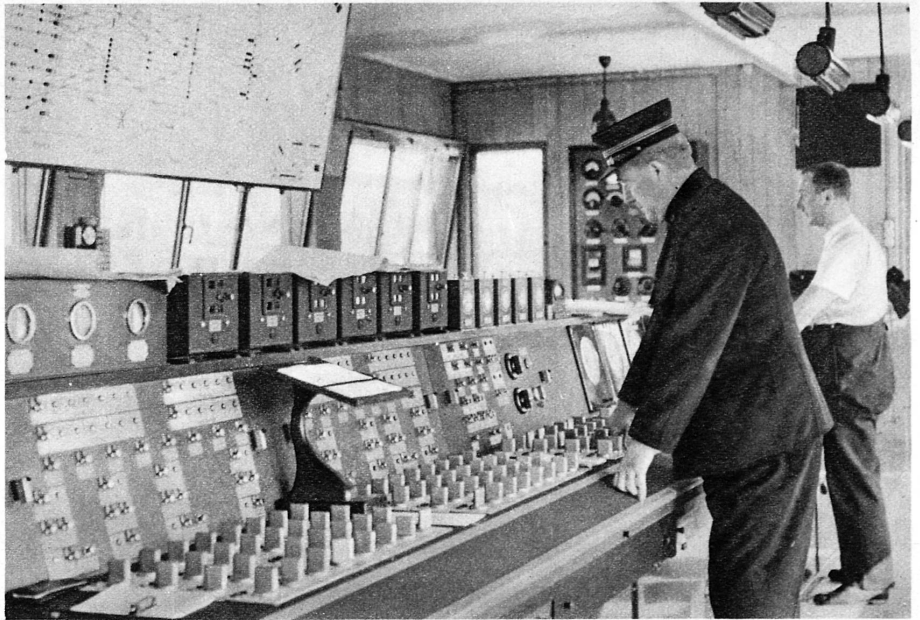
Das Innere des neuen Zürcher Befehlstellwerks: sanfte Schalterdrehung schleust die Züge durch das Schienengewirr der Einfahrt. Das Aufklackern von Kontrollämpchen auf der Orientierungstafel weist die Ausführung der Fernsteuerung nach — Au nouveau poste d'aiguillage de la gare de Zurich: un simple bouton à tourner et le train se dirige sûrement à travers l'écheveau des rails. Une ampoule de contrôle qui s'allume au tableau d'orientation informe que la transmission s'est bien faite au signal
