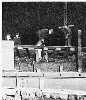
4.30 Uhr. Die Brücke, noch schienenlos am Ziel! Rechts sieht man den Hohlraum unter den Geleisen des Bahnkörpers, der unterklotzt werden muss
