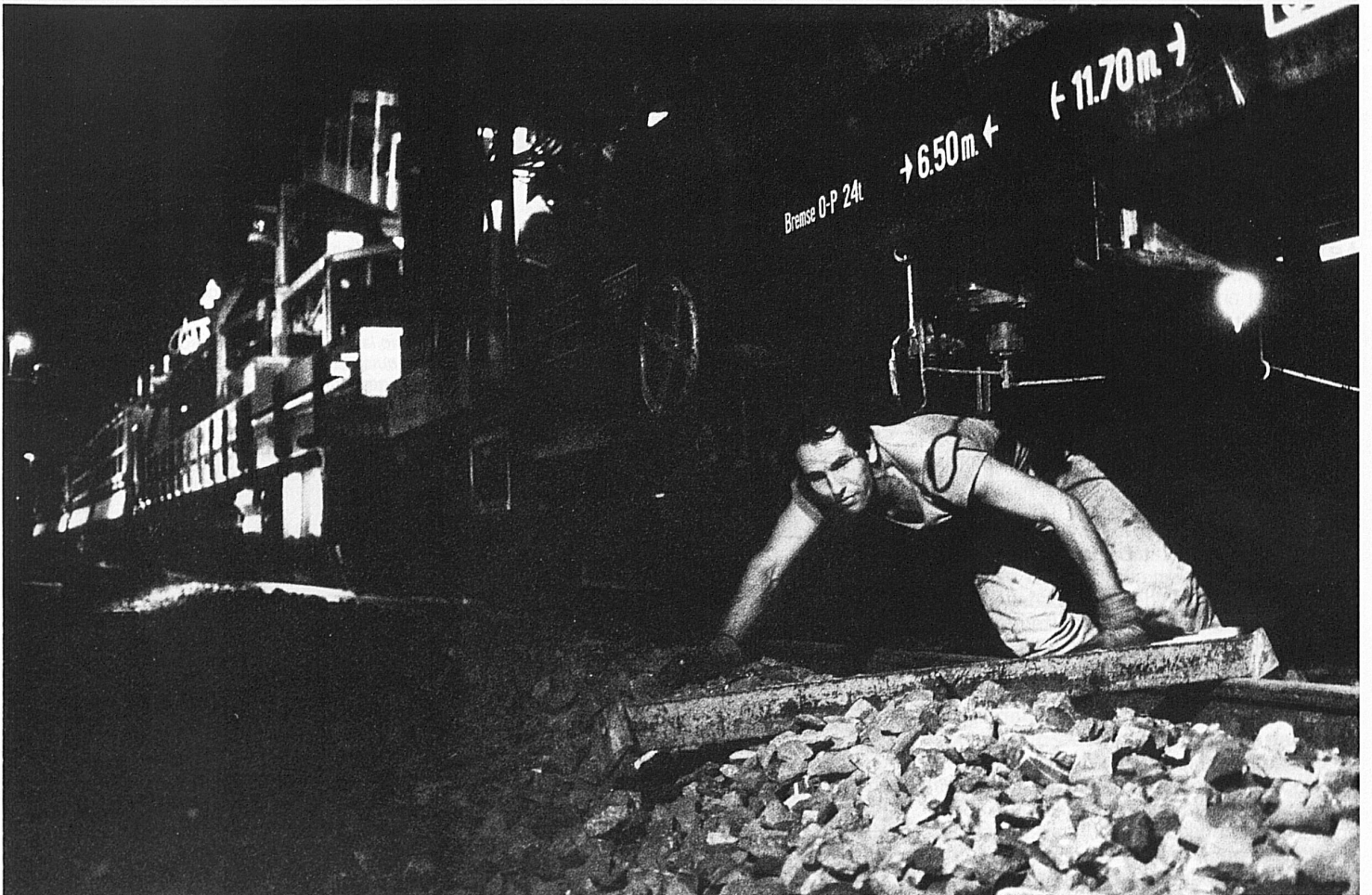
41/42 Altre immagini scattate di notte: in un ambiente quasi spettrale, nell'esiguo spazio fra le gigantesche macchine e la fila di carri merci, gli operai addetti alla posa stendono lo strato di pietrisco e si occupano delle traversine e dei binari
