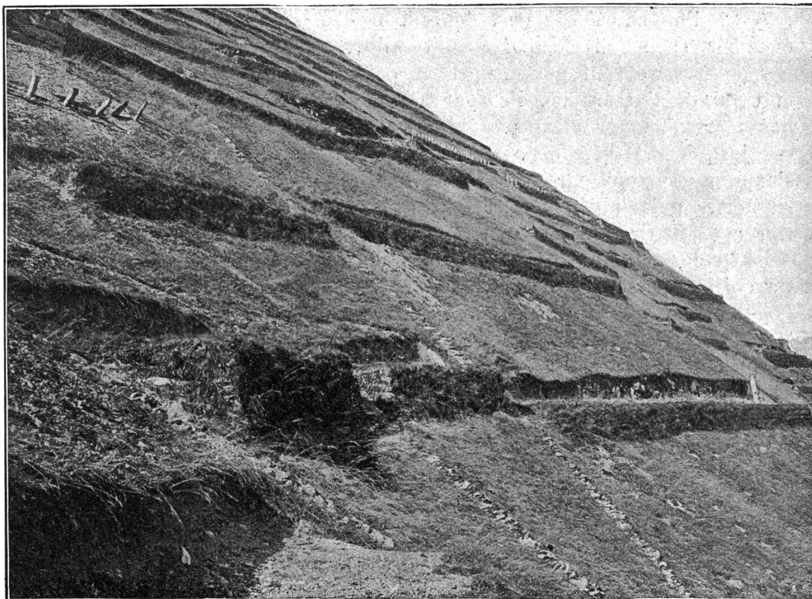
Fig. 2. A la Meissenplanke près d'Elm. Terrasses combinées avec, au premier plan, des couliasses de drainage.
