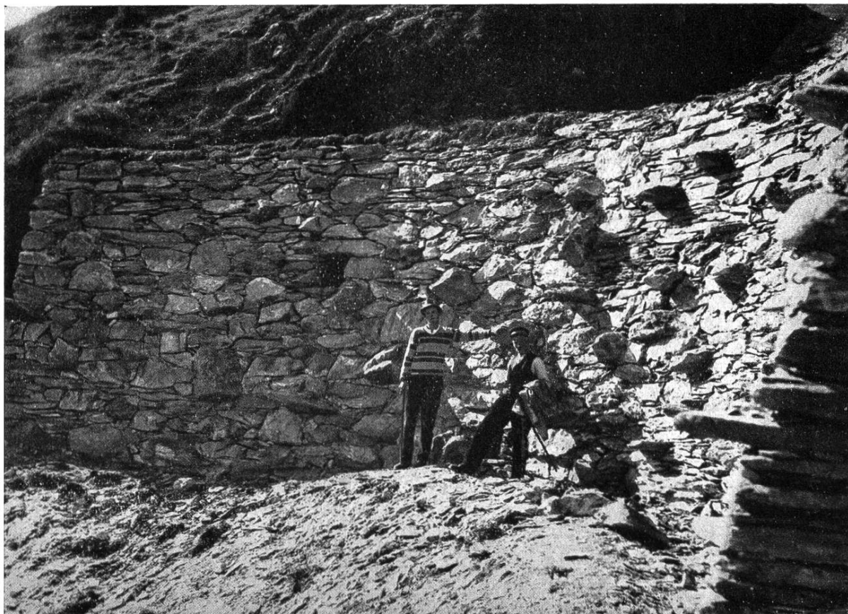
TRAVAUX DE DÉFENSE DE FALDUM MUR CURVILIGNE, AU SCHÖNBÜHL, DANS UNE DÉPRESSION DU TERRAIN Mauvais exemple
