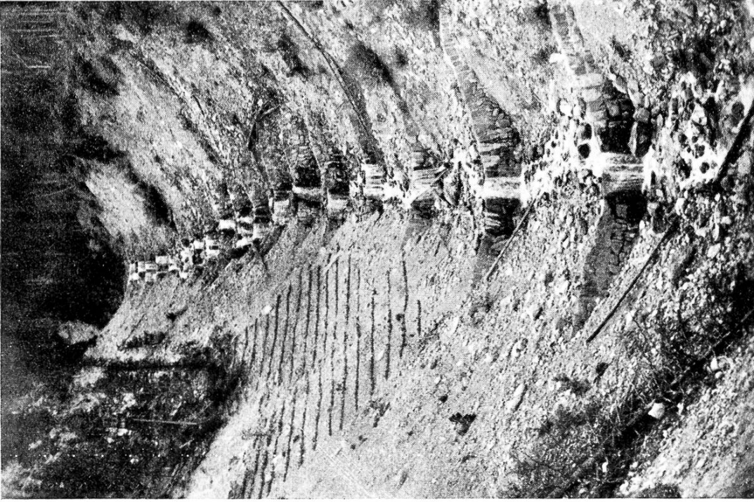
Phot. F. Fankhauser, Kehrsatz. TORRENT DU CHARMAIX, EN SAVOIE. a) Ravin d'Arrondaz. Série de barrages et de clayonnages (1931)
