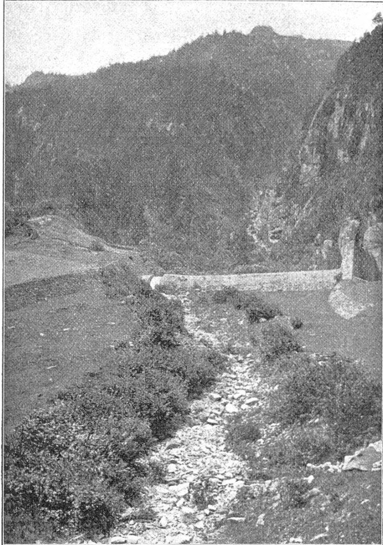
Fig. 3. Galerie gegen die Entschigtallawine an der obern Bahulinie bei Wassen, km 66,070–66,170.
