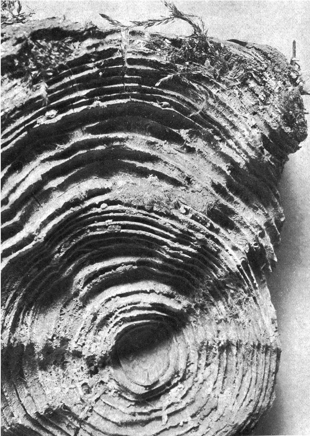
Von Trichopterenlarven angefressenes Stück eines Lärchenholzbalkens Die Fraßgruben (besonders deutlich im oberen Teile) liegen in konzentrischen Ringen
