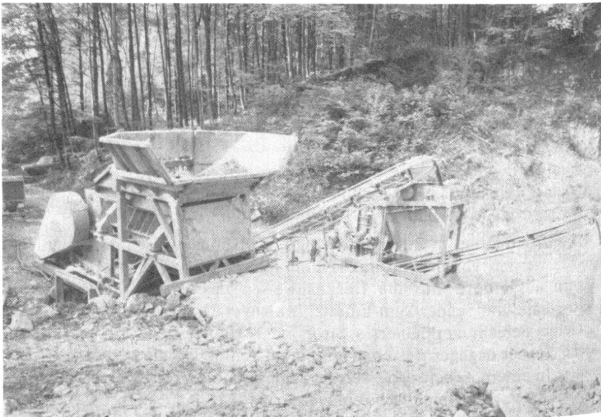
Abbildung 3. Backenbrecher (links) und Hammermühle (rechts) zur Aufbereitung von Trag- und Verschleisschichtmaterial (Photo: Firma H. Renggli, Malter)
