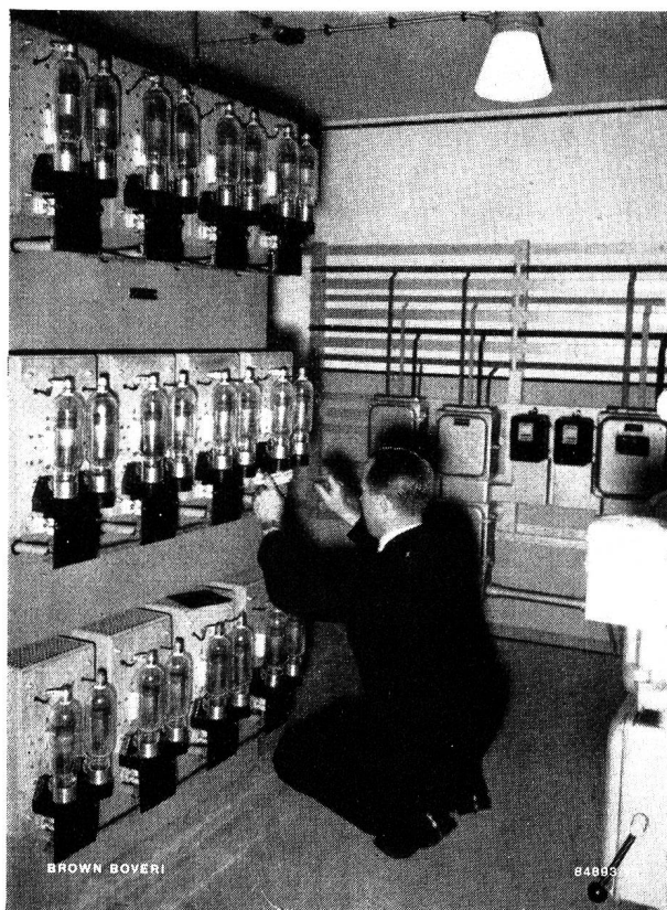
50-kW-Schneisenbeleuchtungsanlage im Flughafen Schiphol (Holland). Mit 12 Thyralux-Geräten, vier je Phase, wird die dreiphasige Anlage stufenlos und trägheitslos gesteuert.
