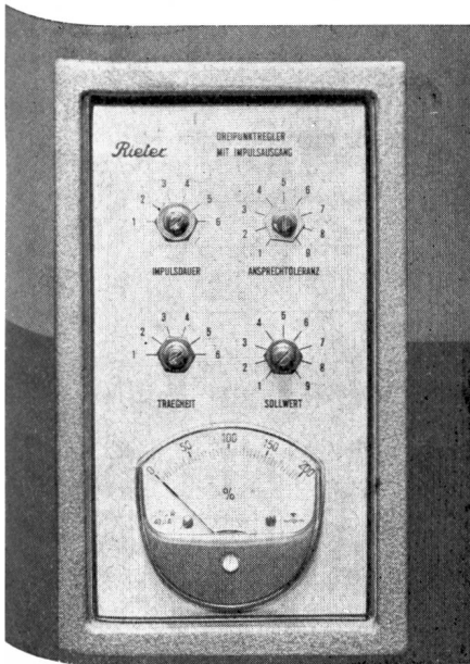
Abb. 19 Dreipunktregler für «Aerofeed»-Regelkreis, eingebaut in Schaltschrank
