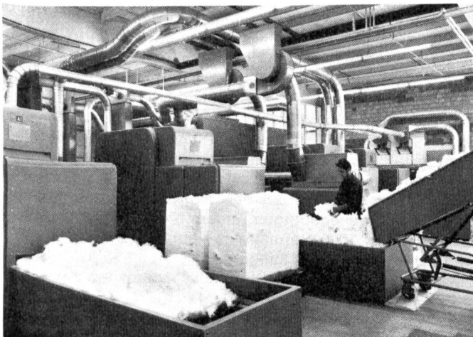
Erfassen der staub- und faserhaltigen Maschinenabluft einer Putzerei und fördern über Rohrleitungen zu den verschiedenen Komponenten der Luwa® Faserdeponie-Anlage.
