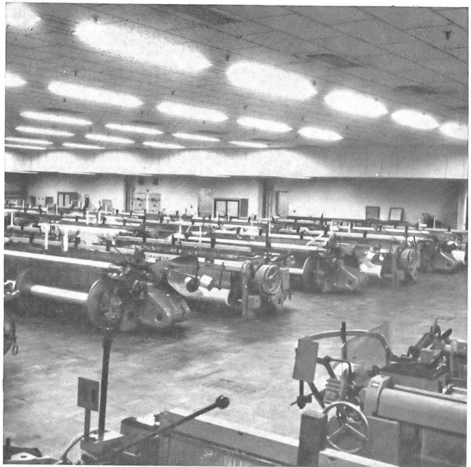
Sprinklernetz in einem grossen Textilunternehmen (0275 5072-3)
