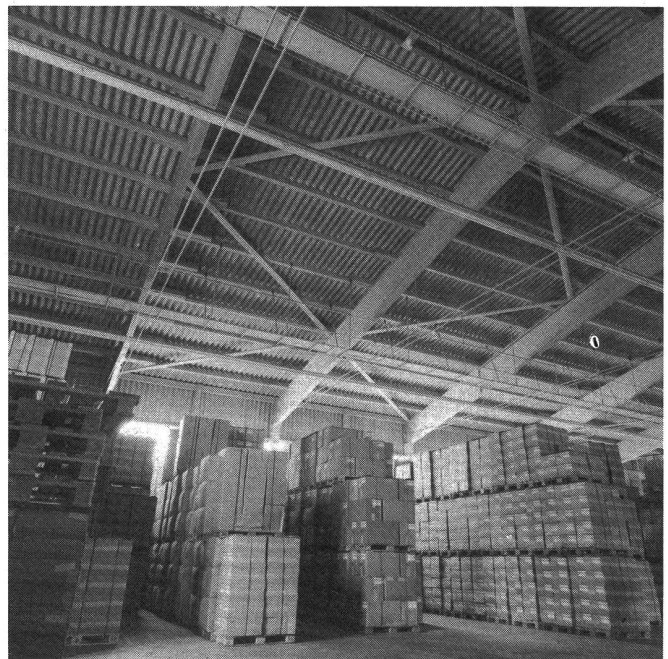
Interessanter Aspekt in einem grossen Lager: Ein Laufgang unter dem Dach erlaubt die problemlose Kontrolle der Brandmelder. (Foto Cerberus)
