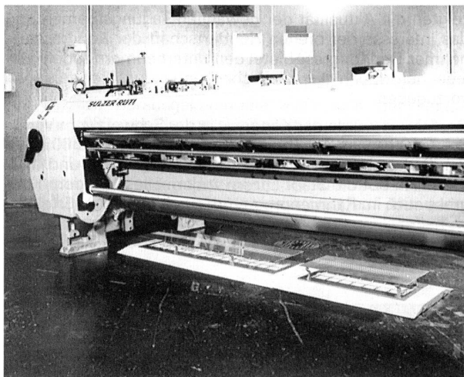
Webmaschine mit Bodenluftauslass für die Arbeitszonenklimatisierung (Foto Sulzer, Nr. 0288 0158-6)
