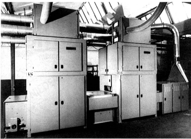
Flockenmischanlage mit Wiegespeisern PWSE, mit elektronischer Waage
