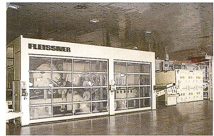
Abb. 4: PES/Pulp-Anlage mit zwei Krepeln mit Faseröffnung, einer Airlaid-Einheit, einer Wasservernadelung, einem Trockner sowie einem Wickler
