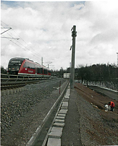
Abb. 5: Test an der Bahnstrecke Dresden-Nürnberg
