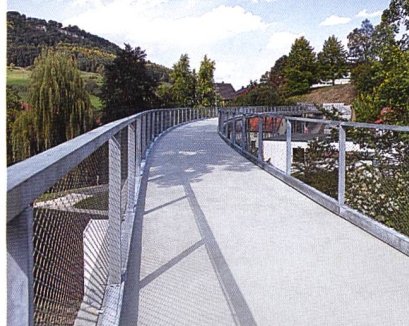
Abb. 4: Kein zusätzlicher Belag
