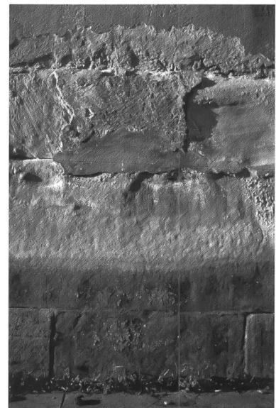
Zementmörtelflicke beschleunigen die Zerstörung des porösen Sandsteins, Zürich, Sihlquai 332
