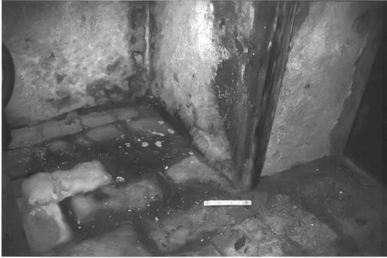
Schäden, hervorgerufen durch in angrenzende Tonplatten und Mörtel eingedrungene Salze aus dem Portlandzement, Zürich, Schulhaus Scherr
