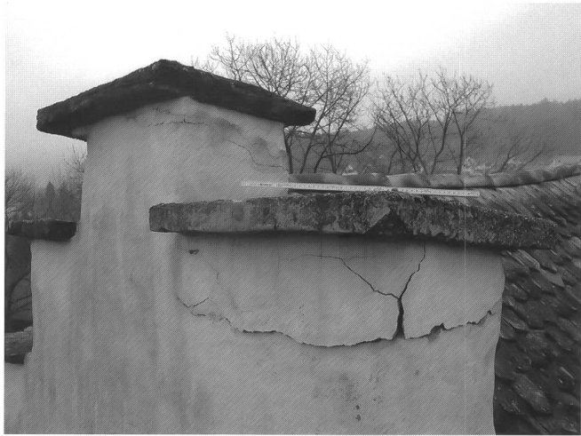
Frostschäden infolge ins Mauerwerk eindringenden Wassers, Untere Mühle, Otelfingen, Fotografie: Andreas Küng
